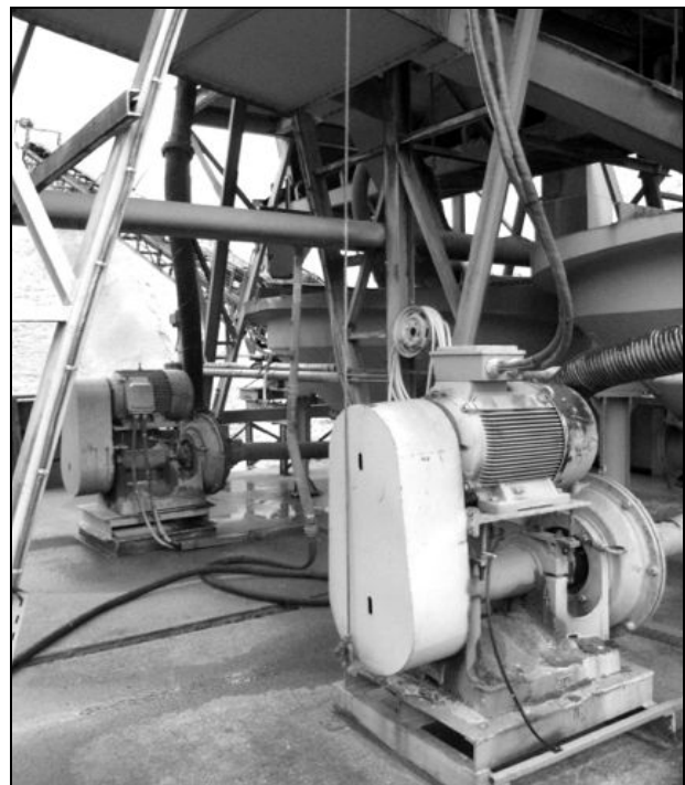
Figure 9 : Pompes de 55 kW
